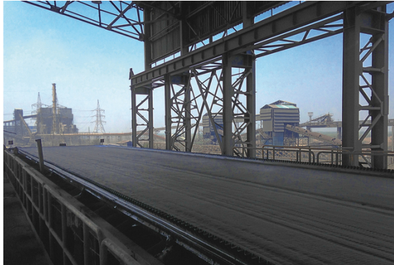
Filtro de banda al vacío en operación
